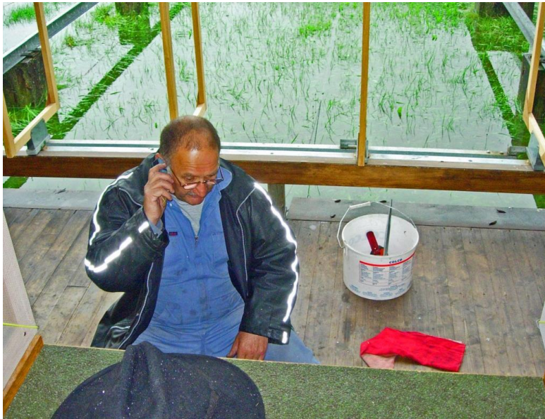
Abbildung 5 Kurt Zähler baut die durchnässten Motoren im 25m-Pistolenstand aus (und meldet den Schaden der Versicherung)
